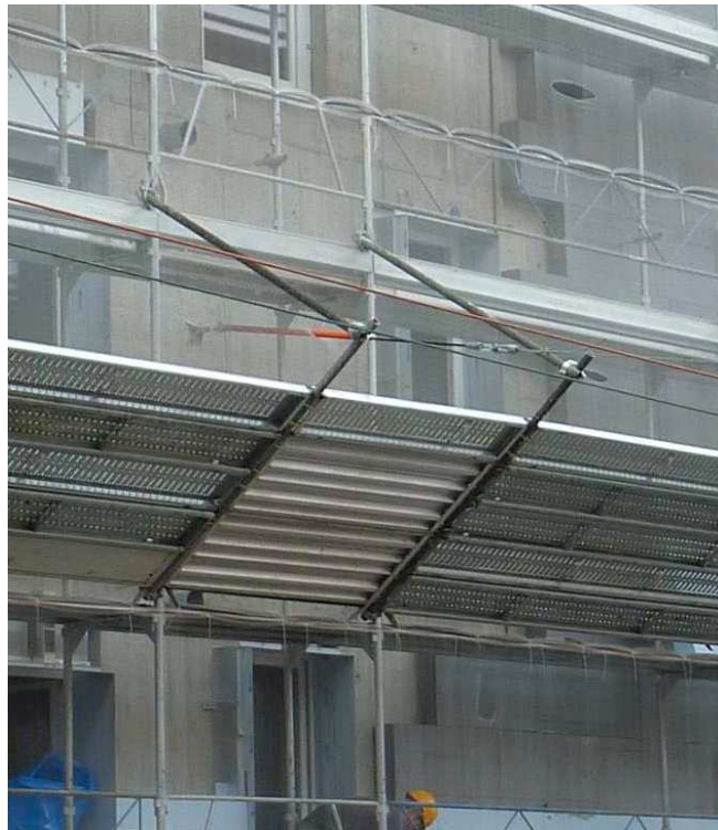
Exemple de protection physique de la ligne de contact
